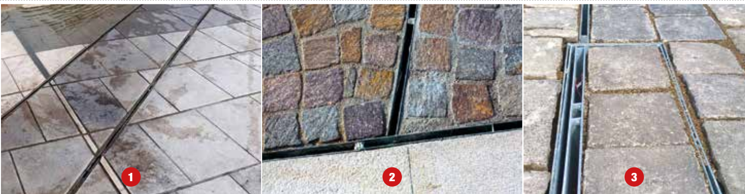
1 2 FOTO DELLA GRIGLIA A FESSURA
